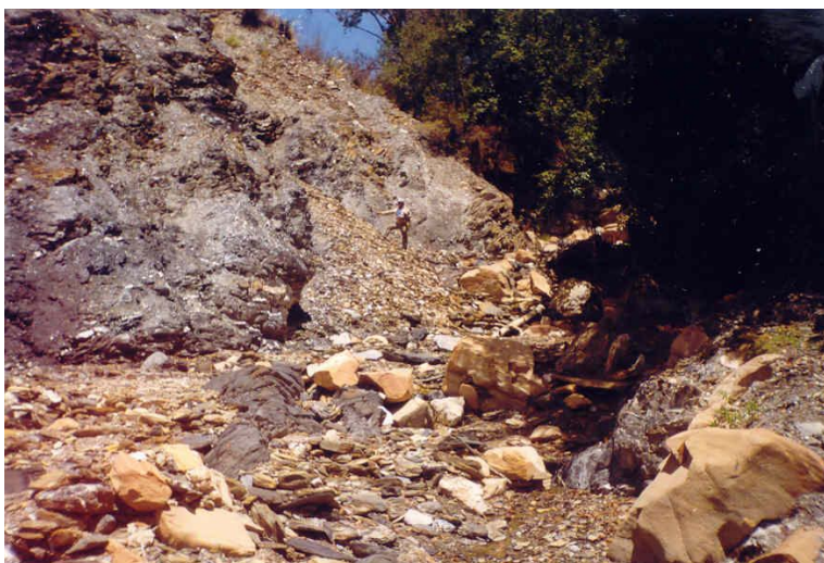
Foto 5: Obsérvese la formación litológica predominante del sector de Oquemayo de la cárcava de Taramayo que no permite la estabilidad de diques y por consiguiente constituye un foco constante de deslizamientos
