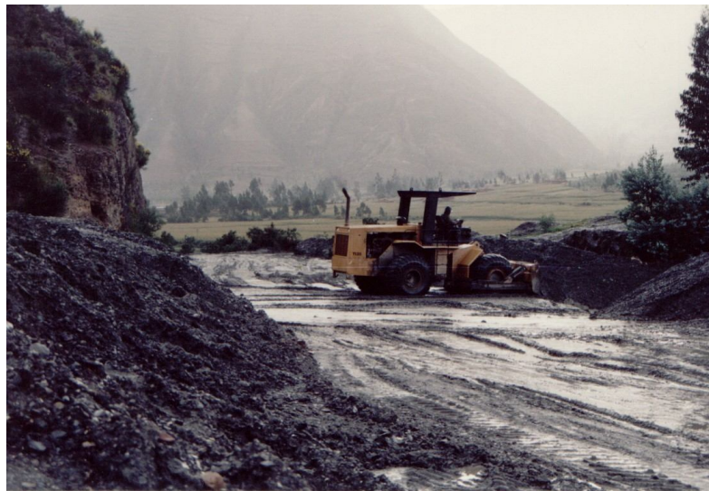
Foto 1: Limpieza de la carretera Cusco- Sicuani (Km 53) después de un huayco proveniente de la microcuenca de Chupanhuaño (año 1992)
